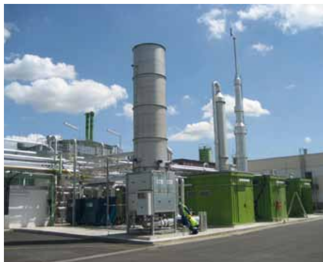
Die Bioerdgasaufbereitungsanlage mit Blick auf Fackel und Waschkolonnen
