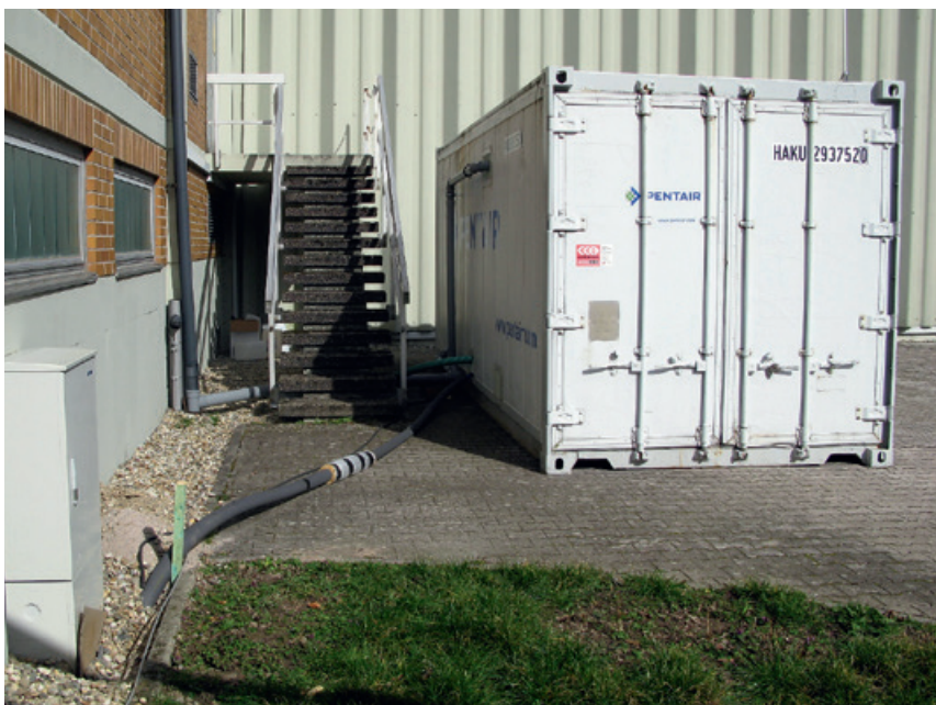
Abb. 1: Containeranlage im Wasserwerk Ottersdorf der star.Energiewerke GmbH & Co. KG, Rastatt
